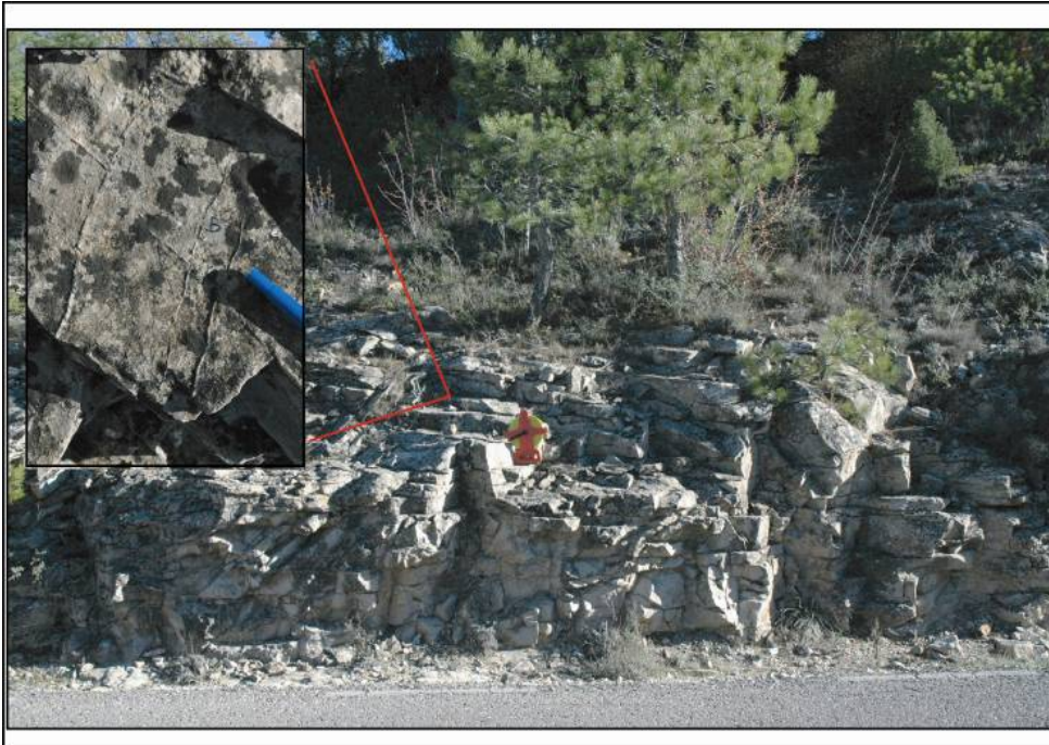
Figura 7.43: Talud del afloramiento 7 con detalle de fracturas rellenas de calcita.
