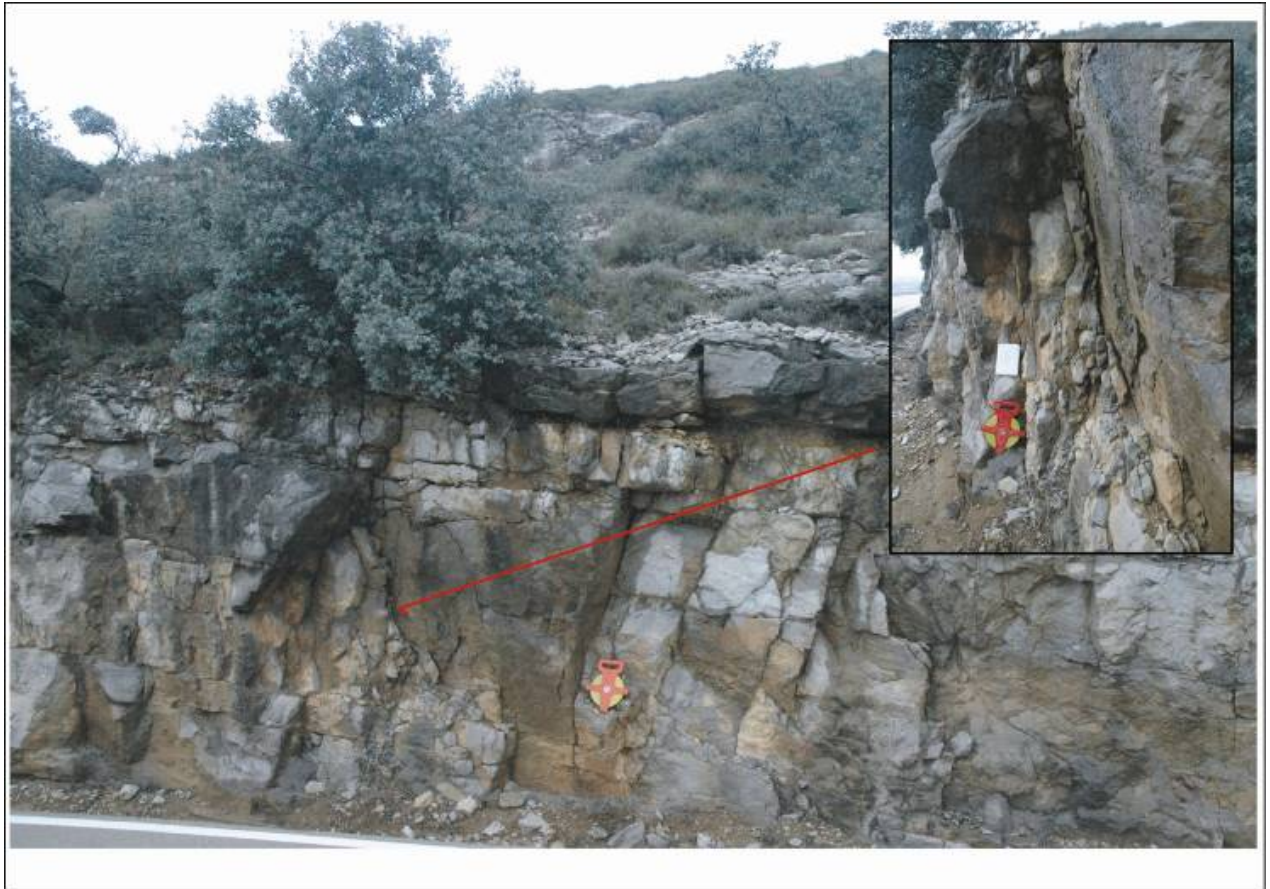
Figura 7.63: Estación 7 y detalle de la fracturación.
