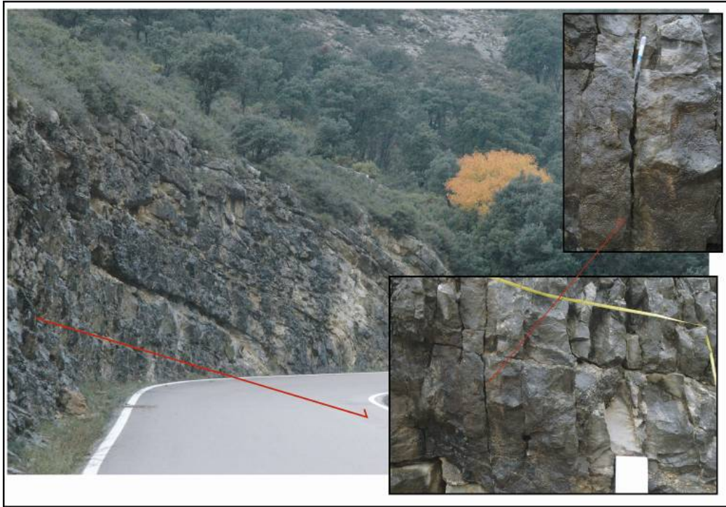
Figura 7.59: Estación 5 y detalles de la fracturación.
